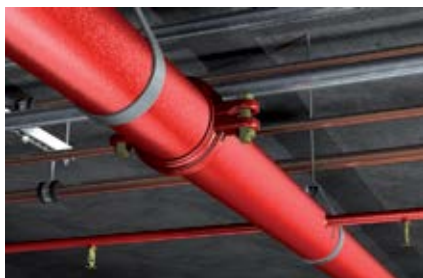
Системы аварийного пожаротушения
