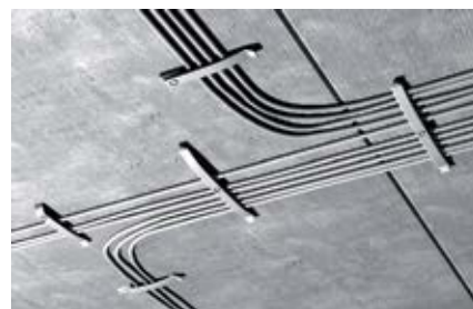
Крепление кабельных линий
