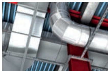
Опорные конструкции для крепления вентиляции
